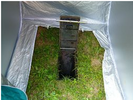
公園のマンホールトイレ
